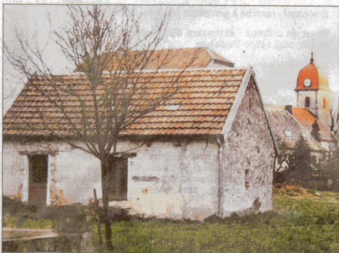
■ La mise à disposition du local technique de la fromagerie-musée est menacée par la vente de la parcelle communale.
